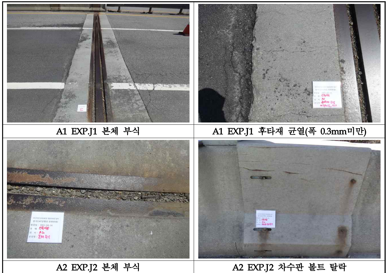
【사진 3.16】 신축이음장치 손상현황
