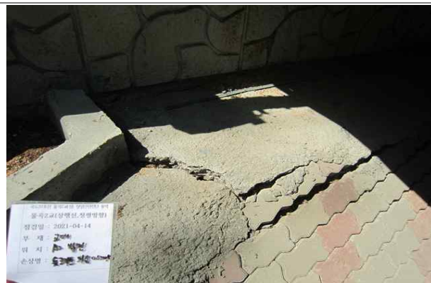
A2 범면 파손(0.5m×0.5m)
