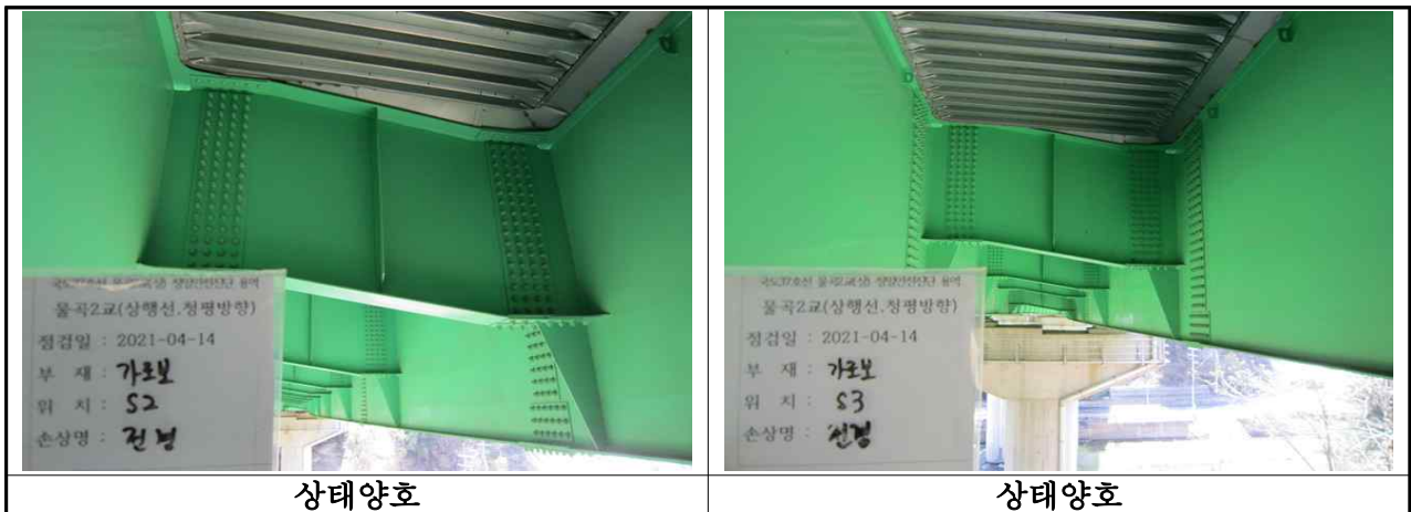
【사진 3.8】 가로보 손상현황
