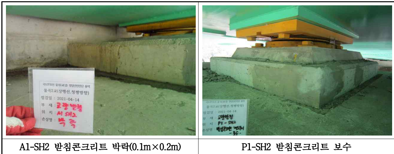
【사진 3.12】교량받침 손상현황
