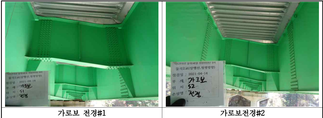
【사진 3.7】 거더 내부 손상현황
