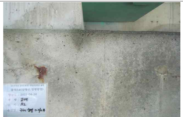
A2 균열(폭 0.3mm미만)
