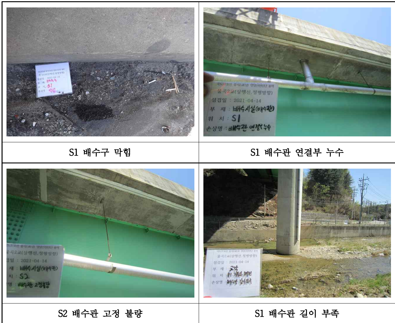
【사진 3.21】 배수시설 손상현황
